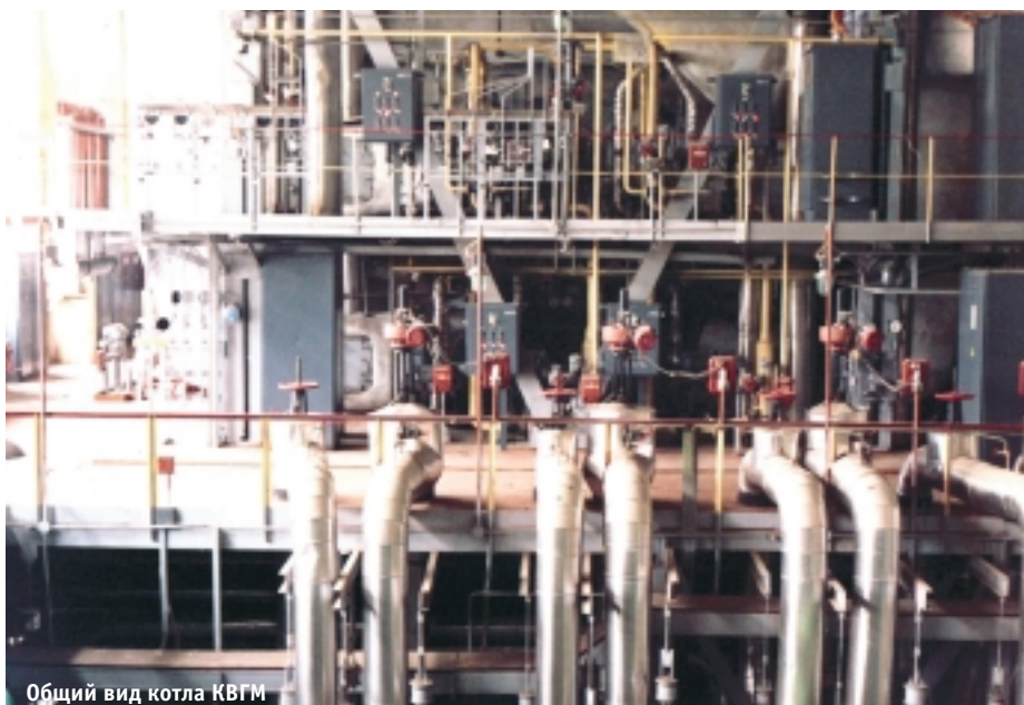
Общий вид котла КВГМ
