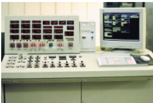
Рис. 3. Аварийно-резервный пульт турбины
