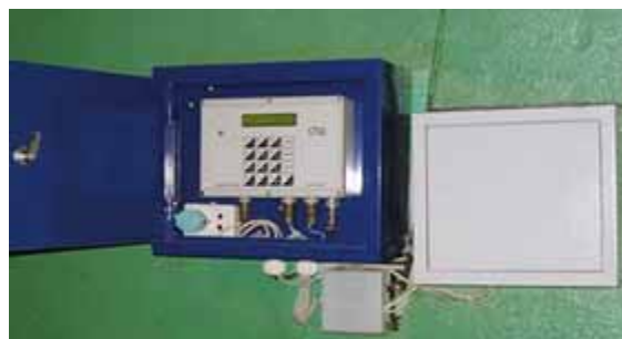
Рис. 1. Узел системы с теплосчётчиком СТД-3
