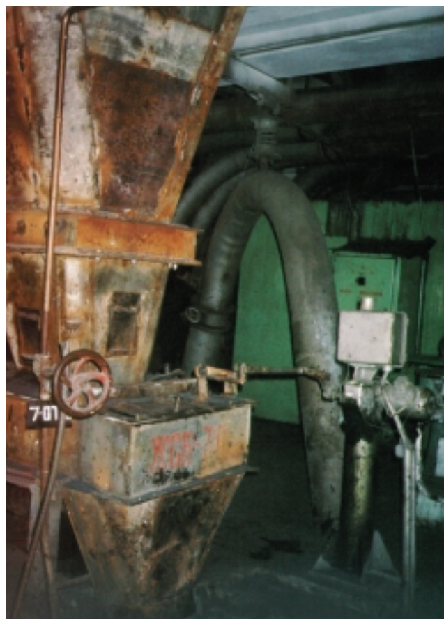
Рис. 6. Питатель сырого угля тепловой электрической станции
