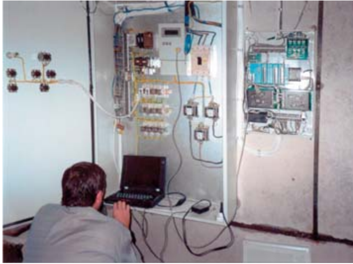
Рис. 11. Рабочий момент настройки оборудования с помощью комплекса технического монитора в одном из тепловых пунктов города Калининграда
