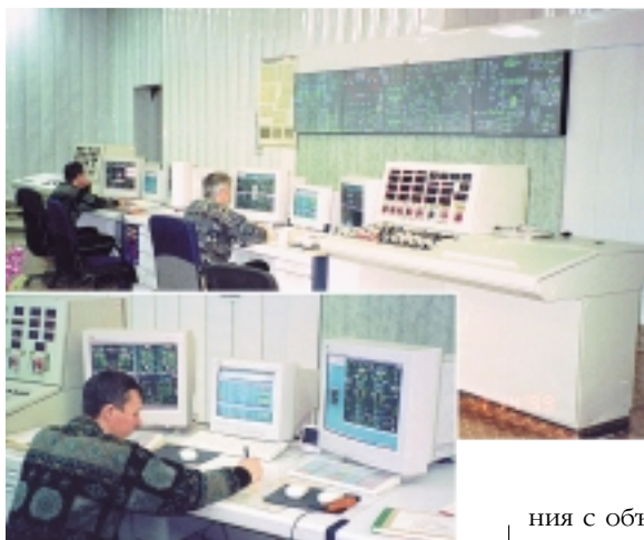
Рис. 2. Общий вид блочного щита управления (БЩУ) и рабочего места машиниста
