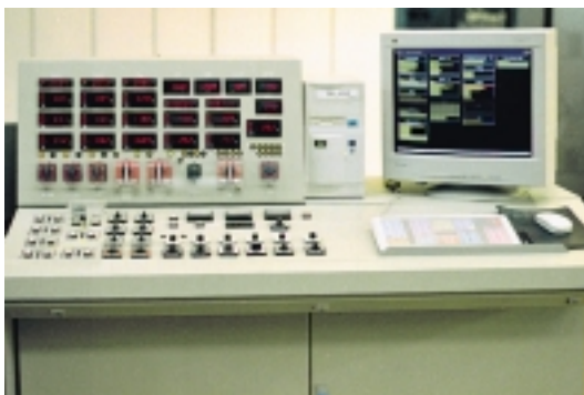
Рис. 3. Аварийно-резервный пульт турбины
